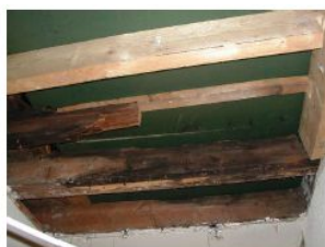
Dakstructuur: een ondeskundige herstelling
