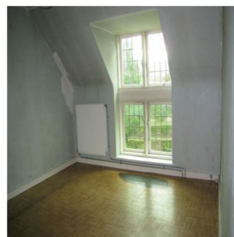
Borstwering onder raam is te laag. Een borstwering van 80cm is noodzakelijk.
