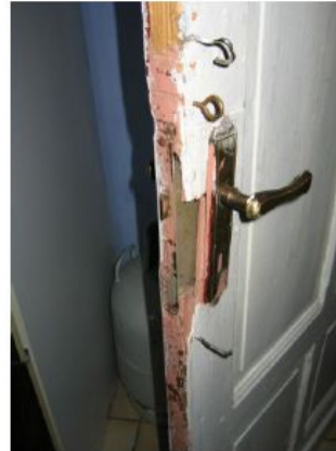
Beschadigd sluitwerk van de inkomdeur.
