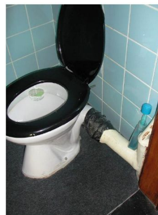
Toilet met gebreken: de afvoerleiding lekt.
