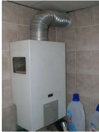
De metalen flexibel als rookgasafvoer is niet conform toegepast. (niet in stijgende helling en ingedeukt)
