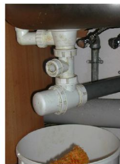
Een gootsteen met gebreken: de reukafsnijder is omgekeerd geplaatst en dus niet functioneel.
