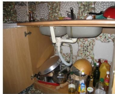
Dergelijke constructies van de afvoer worden niet beschouwd als conforme sifon. Een flexibel komt niet in aanmerking als sifon (= geen reukafsluiter voorzien).
