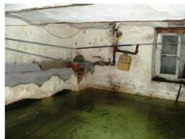
Kelder onder water. In dit geval is ook de gasmeter en de hoofdkraan van het water niet bereikbaar, waarvoor een extra quotering gegeven wordt. Merk op: links bovenaan langs het raam ziet men de sporen van een kelderzwam.
