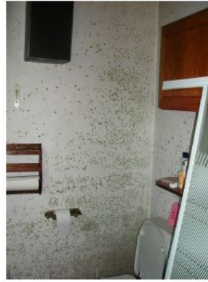
Condenserend vocht met schimmelvorming
